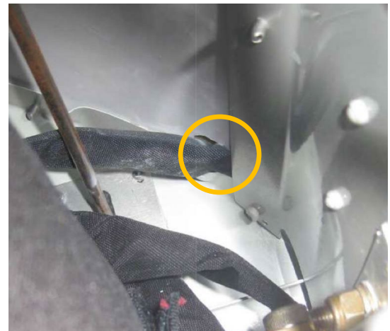
Fig. 3: foto desde el interior de una instalación mostrando el orificio en el panel de escape
